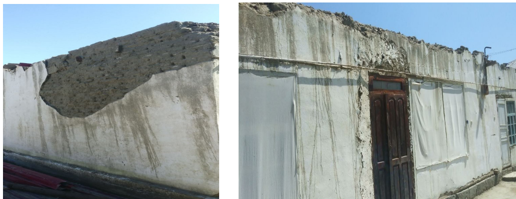
Рис.1. Разрушение сельских домов после воздействия урагана
