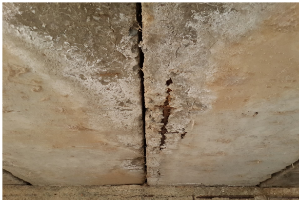
Рис. 3. Автодорожный мост через коллектор расположен на км 1+000 автомобильной дороги 4Р176г («подъезд от автомобильной дороги 4Р176 к автомобильной дороге 4Р175»). Дефекты конструкций опор по причине солевой агрессии
