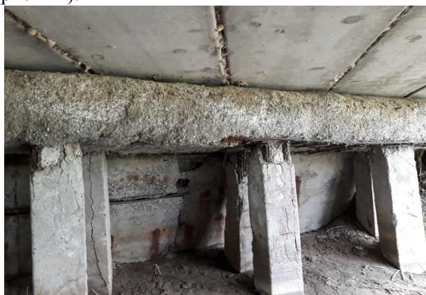
Рис. 1. Коррозия бетона по причине солевой агрессии к опоре моста на км 12+952 автомобильной дороги 4Н44 «Куrolпа ДФХ – Караузяк ДФХ»
