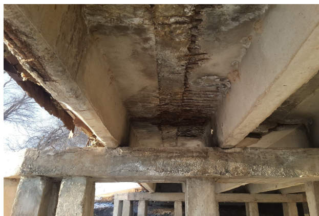
Рис. 2. Коррозия бетона по причине солевой агрессии. Автодорожный мост через канал Кегейли расположен на км 8+900 автомобильной дороги 4Р178 («железнодорожная станция Кумшунгул – Аспантой»)
