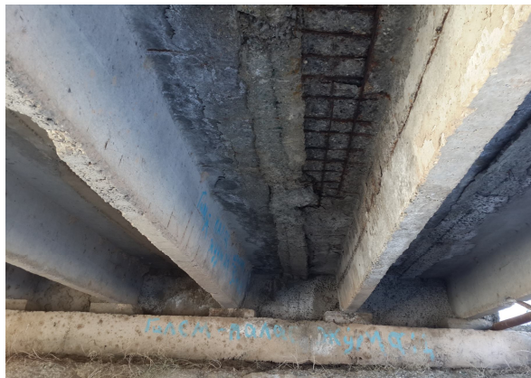
Рис. 4. Автодорожный мост через канал «Галлык» расположен на км 10+925 автомобильной дороги 4Р173 «Кунград – Муйнак». Дефекты конструкций опор по причине солевой агрессии
